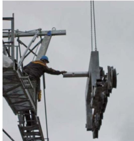
Le guidage prématuré de la charge à la main est une prise de risque inutile. Sur cette situation, la charge est encore en approche. Il faut laisser le pilote amener le colis au plus près de l'endroit prévu. L'opérateur au sol ne le guide qu'au dernier moment pour réduire les risques d'écrasement liés au mouvement de la charge.
